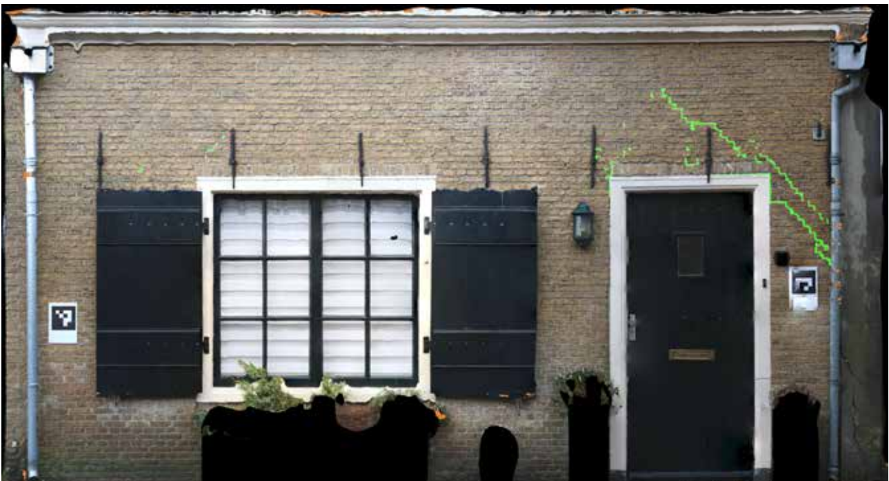
Figuur 6: gedetecteerde scheurvorming in gevel aanzicht (Asset Hub)
