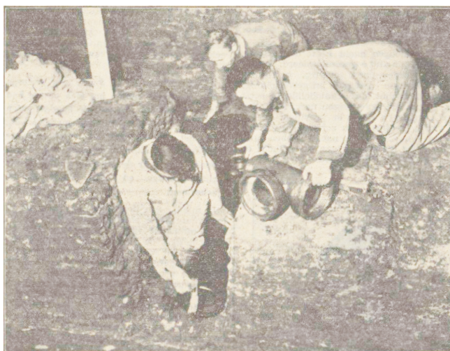
WATERLEIDINGBUIZEN REDDEN EEN KERK. — De R.K. Parochiekerk te Woerden, die sedert 1892 met haar hoogen toren het stadsbeeld beheerscht, lijdt onder het euvel, dat de helptalen , die haar dragen, te droog staan. Dientengevolge toonen zij reeds sinds langen tijd ernstige verrottingsverschijnselen. Het wel meer toegepaste systeem om de fundering te veranderen, was in dit geval niet uitvoerbaar, en de kerk zou onherroepelijk tot een ontijdig einde zijn gedoemd, als men er niet iets heel vernuftigs op had gevonden, dat (naar deskundigen verzekeren) een unicum in den lande is. De bouwkundige adviseurs van het Kerkbestuur zijn er namelijk toe overgegaan, onder het geheele gebouw een net van buiten met grindbed aan te leggen, dat eeriang met den nabijgen Rijn zal worden verbonden, waardoor op die plaatsen waar het noodig is, het Rijnwater toegevoerd zal kunnen worden. Enkele maanden geleden is men aangevangen met het werk; tegen den komenden zomer hoopt men er mede gereed te zijn. De foto toont het verbinden van de omvangrijke buizen in een der gewoelen onder de kerk. Men is hier op overblijfselen der stadswallen gestuit, die gedeeltelijk zullen moeten worden weggebroken.
