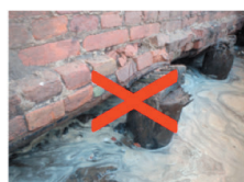
Funderingsschade (palen en op staal gefundeerd)
