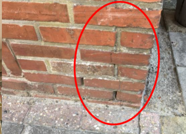
Scheurvorming in de linkerzijgevel van de aanbouw.
