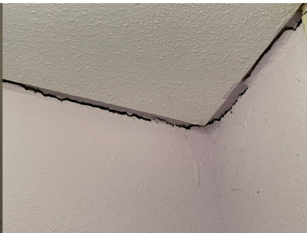
Scheurvorming in de wand/plafond van het toilet.
