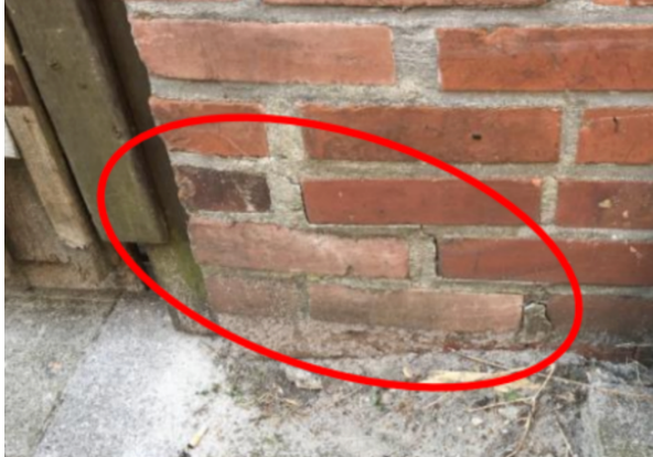
Scheurvorming in de linker achterhoek van de zijgevel van de aanbouw.
