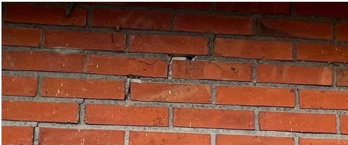
Figuur M1: Aangetroffen schade
