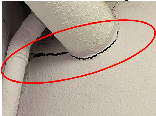
Scheurvorming in de wand van het toilet.
