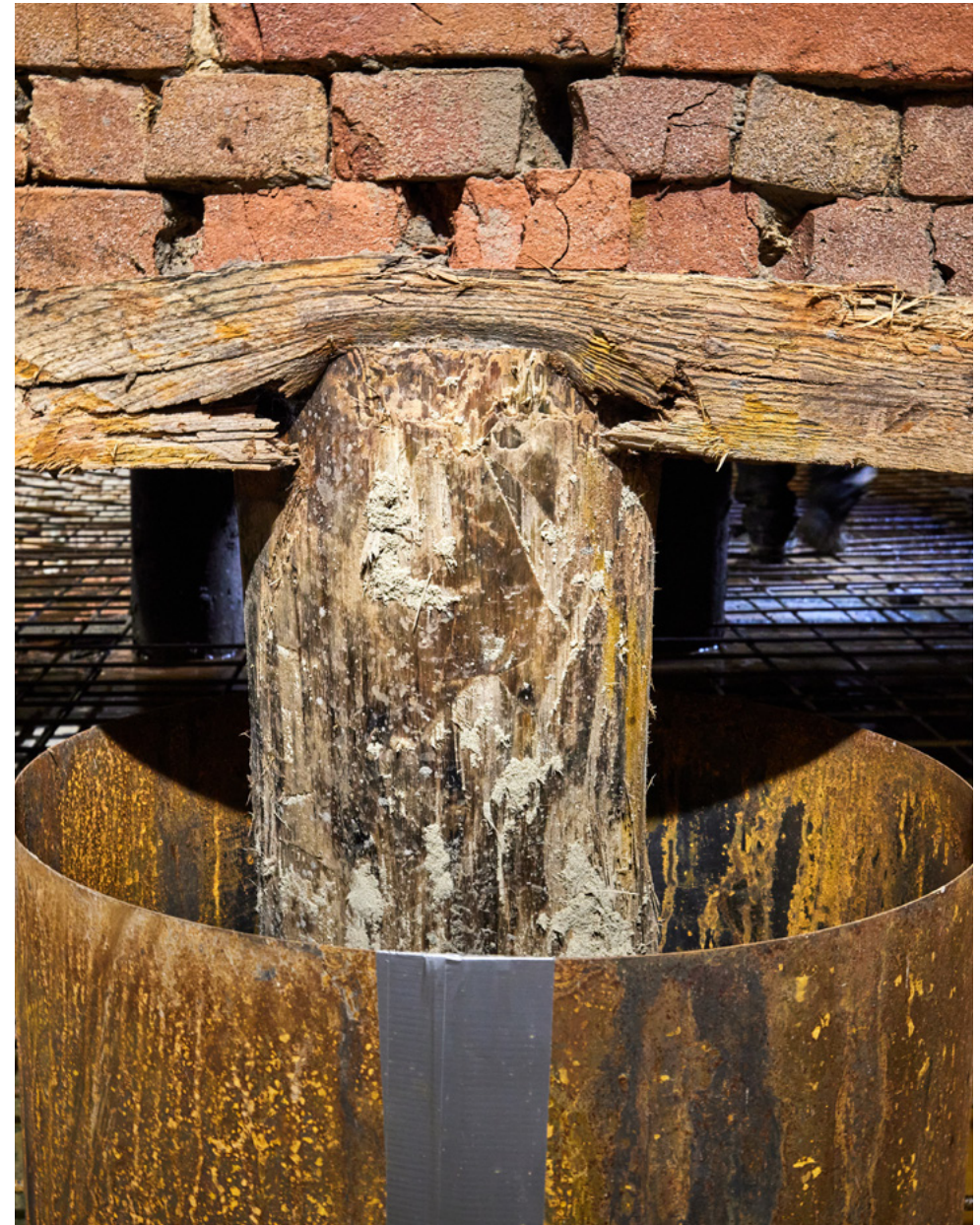
Houten paalfundering met schade (niet in de onderzochte gebieden)
